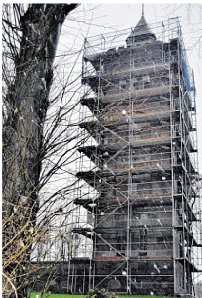
Der Bismarckturm auf dem Scheersberg muss dringend saniert werden. KÖHLER
